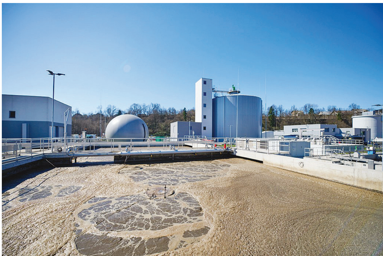
Centralna čistilna naprava Kranj / Foto: Samo Paušer
